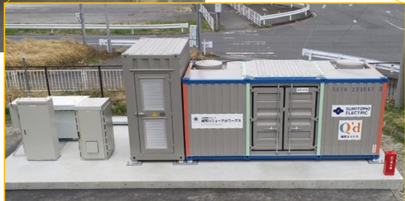
納入したレドックスフロー電池
